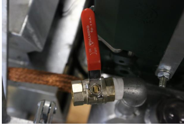
Abb. 41. Entlüftungsventil in geschlossener Stellung
